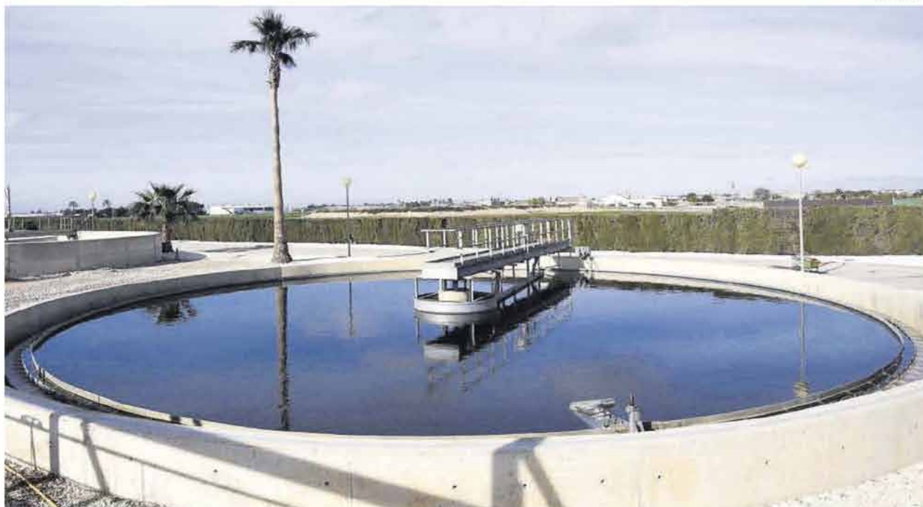
Imagen del proceso de decantación en la Estación Depuradora de Aguas Residuales de Torre Pacheco
