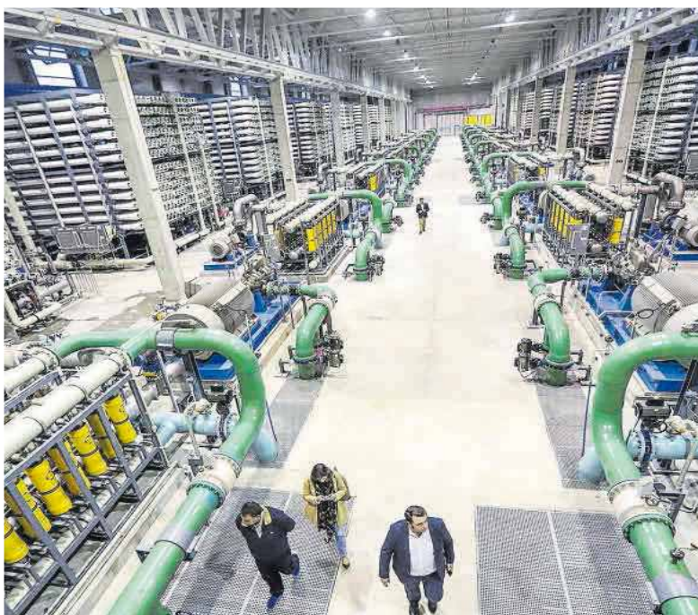
Interior de la planta desaladora de Torrevieja.
