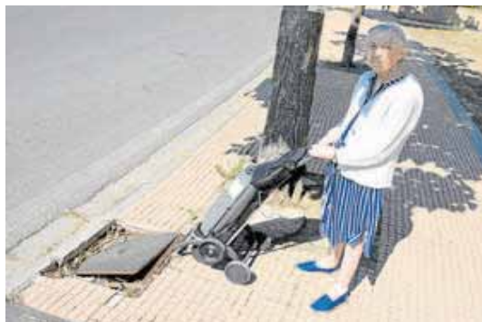
Herminia junto a la arqueta días antes de su reparación. ARNELAS
